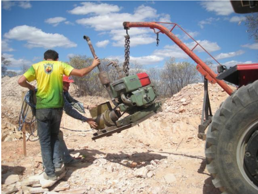
Figura 7 – Gerador utilizado para fornecer energia à máquina. Fonte: Pereira.
